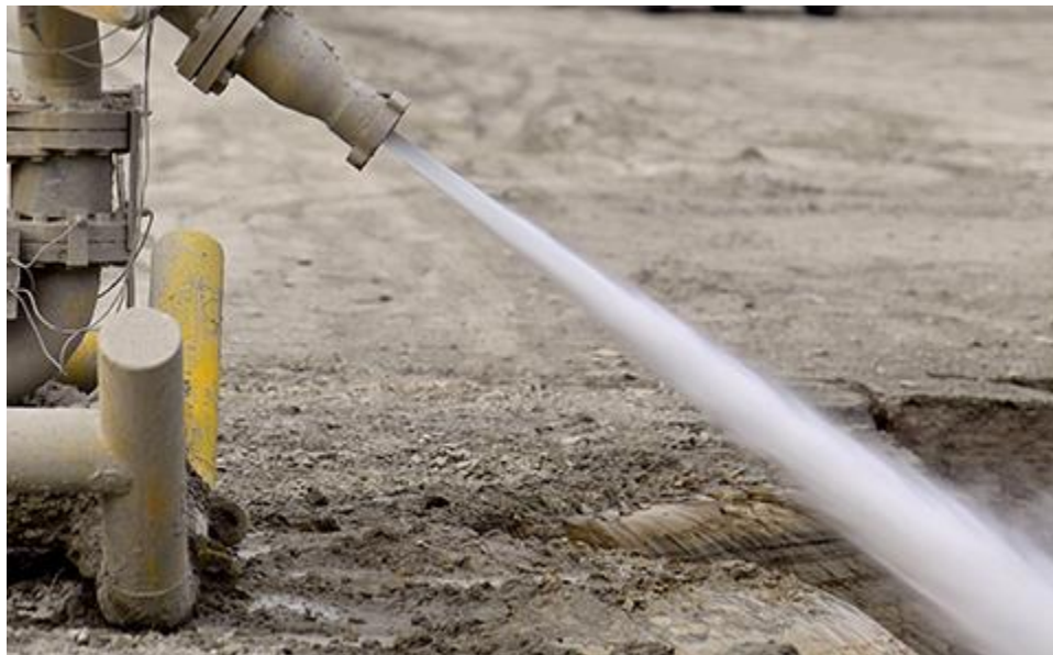
Ilustración 2: Pitón del Monitoreo Hidráulico. Fuente: MVC.
