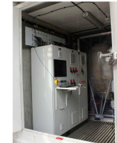
Sala de control
