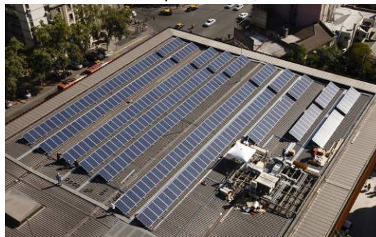
Imagen aérea planta FV 100 kWp GAM, proyecto PTSP.
